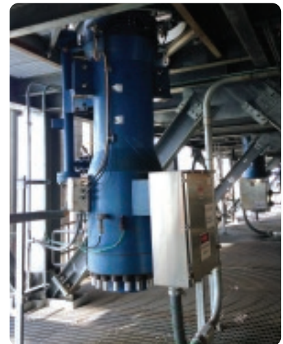
安装在印第安纳州爱德沃斯堡的 合成气辐射冷却循环泵
