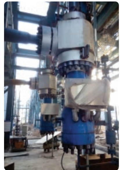
两台安装在中国的BDO反应器循环泵，额定功率149 KW，设计压力399.9 bar
